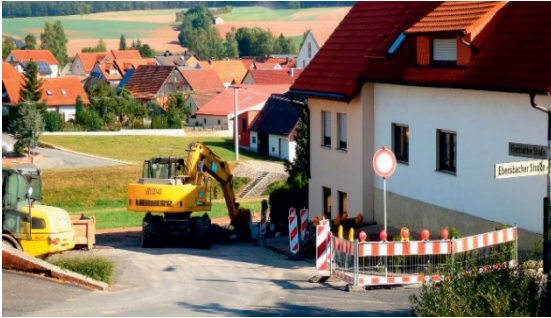
Kreuzung Ebersbacher Straße. / Lange Eller / Talweg. Hier soll die Ableitung des Oberflächenwassers verbessert werden.
